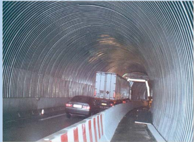
用12000平米的不锈钢网来确保剥落的混凝土不会掉入车流中
